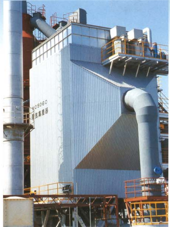
形式/3HD-43 用途/空港焼却炉 ガス量/51,000Nm 3 /Hr ガス温度/250℃
