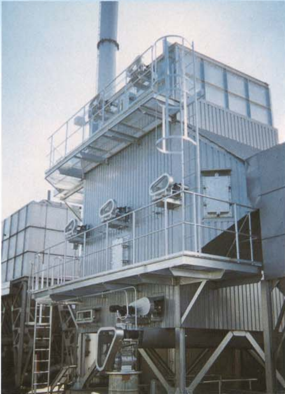
形式/2HD-8 用途/木屑焚ボイラー ガス量/8,200Nm 3 /Hr ガス温度/300℃
