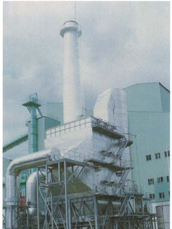
形式/3HD-77 用途/硝子溶解炉 ガス量/80,000Nm 3 /Hr ガス温度/500℃
